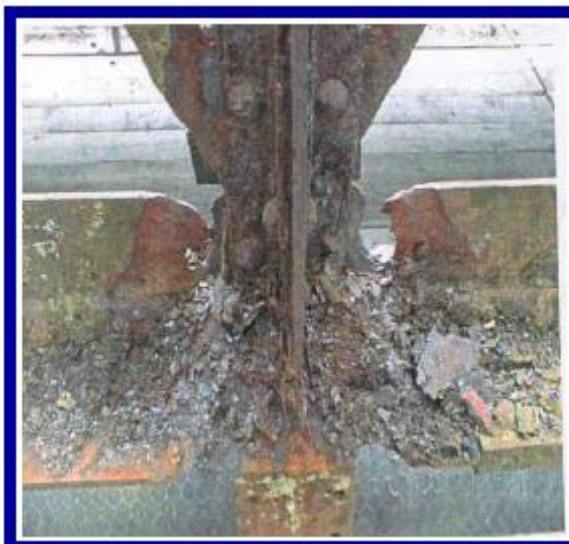
Поврежденные коррозией узлы
