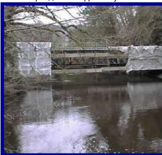
На период восстановительных работ мост был обнесен лесами, закрыт тентом, и были установлены временные опоры.
